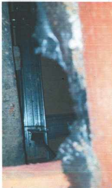
Фото № 24 – место вскрытия перекрытия (пространство под балками) (обследование конструкций фото от 07.10.2021г.)
