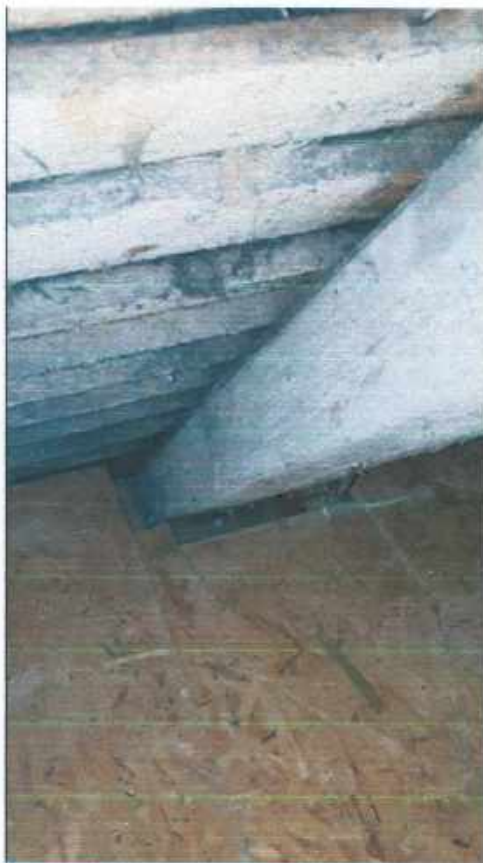
Фото №15 – вид чердачного перекрытия со стороны чердачного пространства (примыкание стропильной ноги) - (обследование конструкций фото от 07.10.2021г.)
