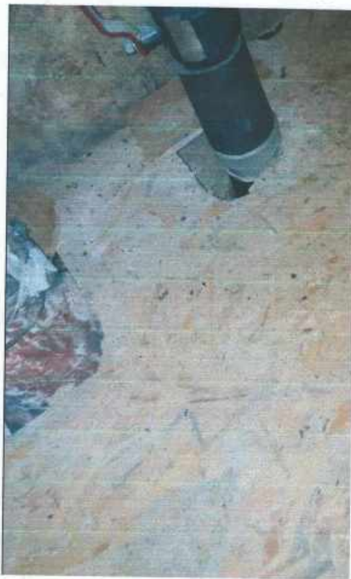
Фото №18 – вид чердачного перекрытия со стороны чердачного пространства (место прокладки коммуникаций через перекрытие) - (обследование конструкций фото от 07.10.2021г.)
