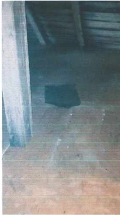
Фото №19 – общий вид со стороны чердачного пространства места вскрытия перекрытия (обследование конструкций фото от 07.10.2021г.)
