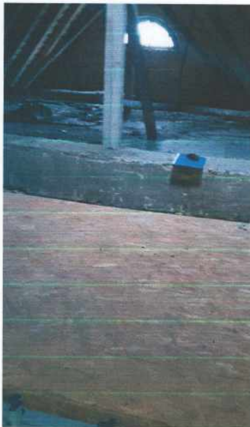
Фото №9 – вид чердачного перекрытия со стороны чердачного пространства (обследование конструкций фото от 07.10.2021г.)
